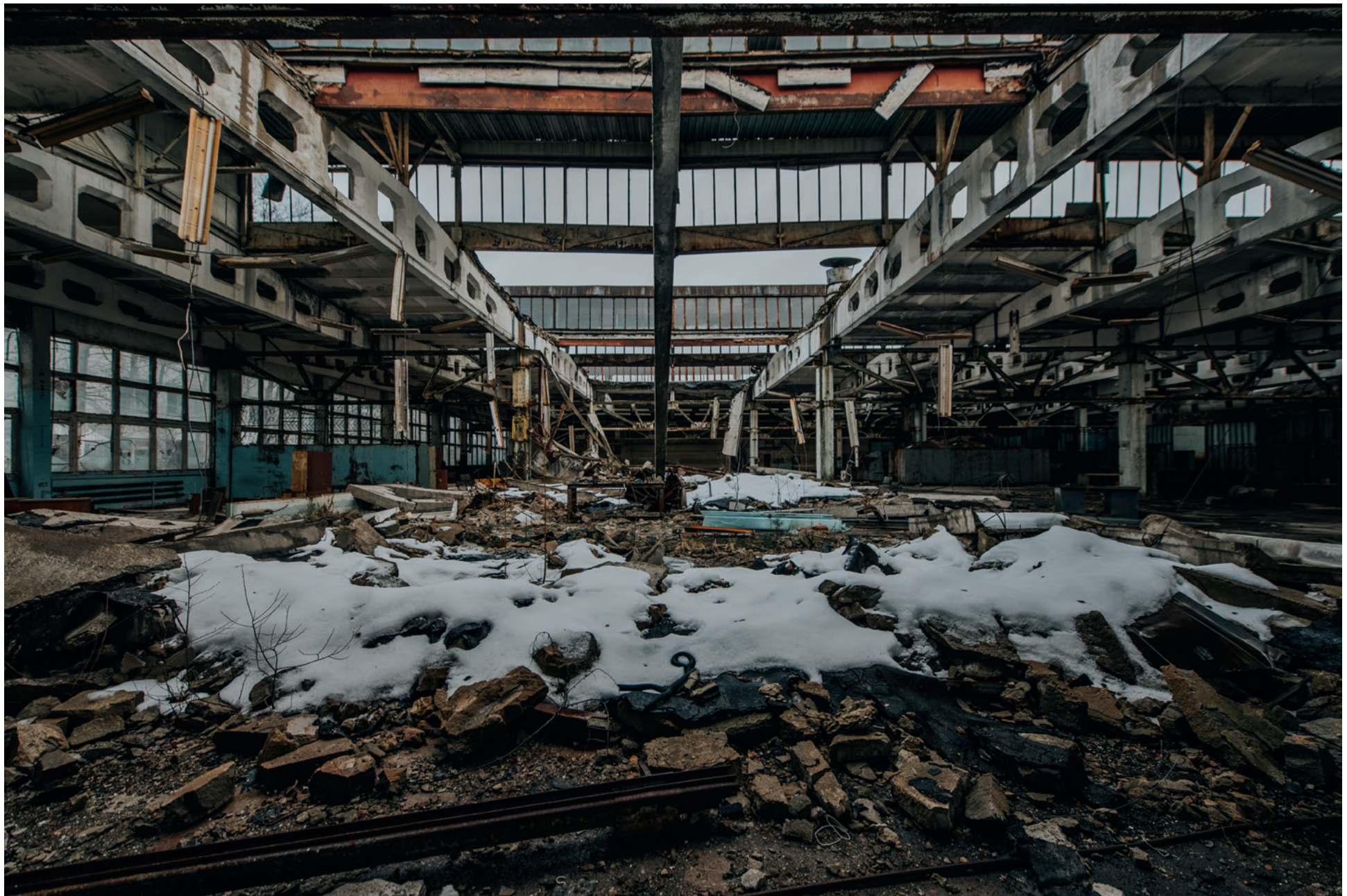
Usine de construction aux abords de Prypiat. En partie écroulée, la neige s'y infiltre.
