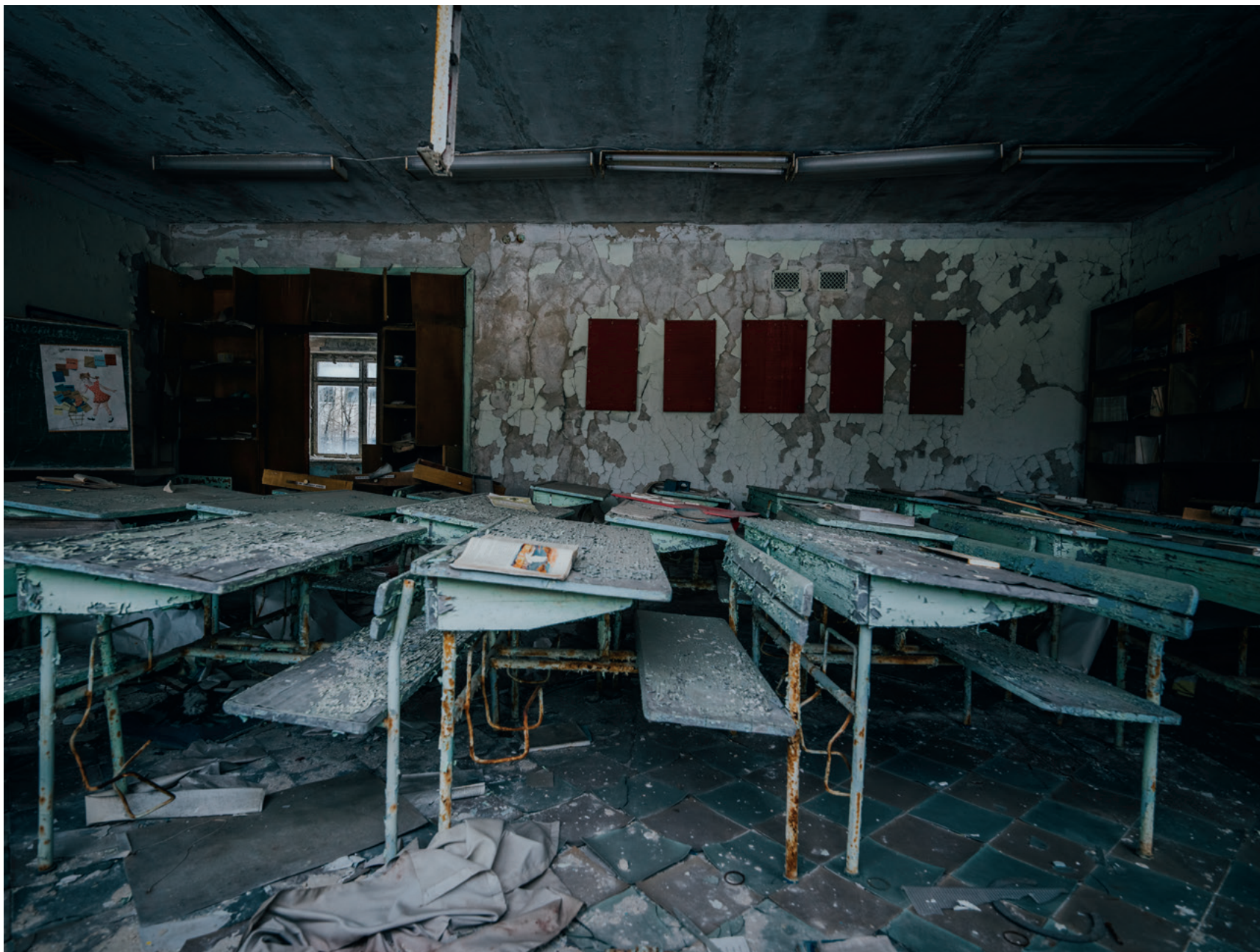
Salle de classe de la ville de Prypiat. Photo prise depuis la fenêtre extérieure car ce bâtiment est déjà en partie effondré.
